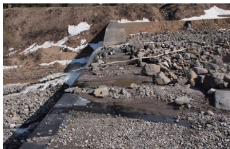
▲ラバースチール設置状況(RS-F50、RS-C50) (平均摩耗速度0.26mm/年、経過年数18年時)
