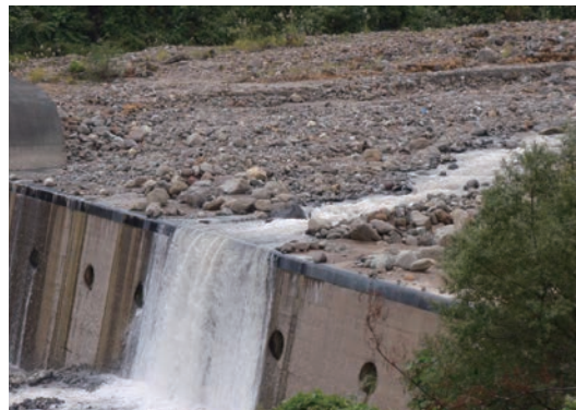
▲ラバースチール設置あり(経過年数18年) (位置：左記砂防堰堤の上流) 下流のコンクリート製砂防堰堤が、10年で最大約10mの摩耗を受ける環境下でもラバースチールは健全に機能しています。
