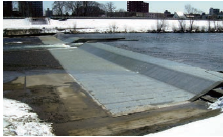
▲北海道開発局札幌開発建設部札幌河川事務所 豊平川15号床止護床工 (北海道)
